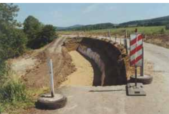
Odtěžení zemin porušených sesuvem až na únosné podloží, vytvoření drenážní písčité vrstvy
