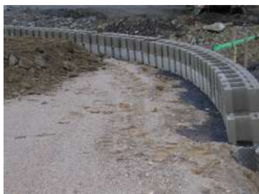
Detail pokládky litvých segmentů (tvarovek). Výztužná geomříž Armatex® G 55/30 je vložena do ložné spáry každé druhé vrstvy.
