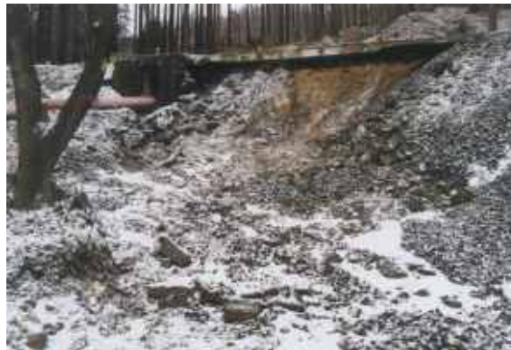
Obr. 2 Pohled na sesuv silnice z akumulární oblasti
