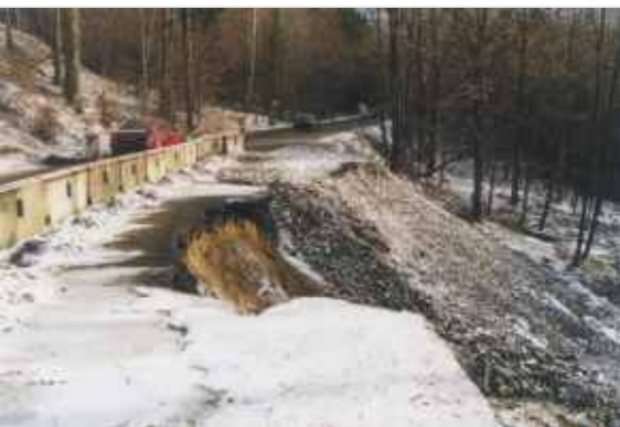
Obr. 1 Silnice po sesuvu (11/98)
